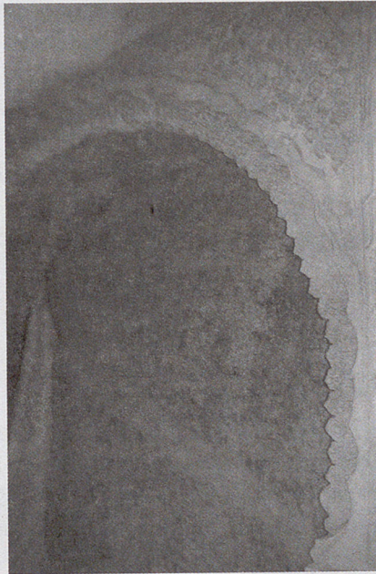
Figura 13. Estado actual en el Hotel Laredo.
